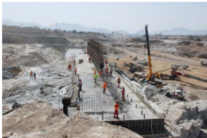
Da tempo si registra un notevole coinvolgimento cinese nel settore idroelettrico in Etiopia, per esempio nella realizzazione – molto controversa per varie ragioni – delle dighe Gilgel Gibe III e Grand Ethiopian Renaissance Dam (Gerd) (sopra). In entrambi i casi l'impresa costruttrice è l'italiana Salini Impregilo.
